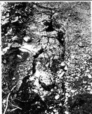
水沢流ノ沢町道の地割れ
