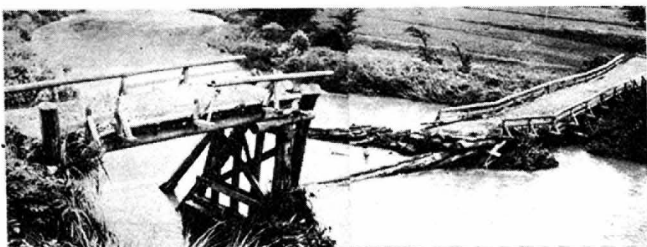
流失した寺庭橋(長さ57メートル)
