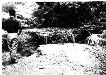
流の沢橋の流失で奥地と交通絶える
