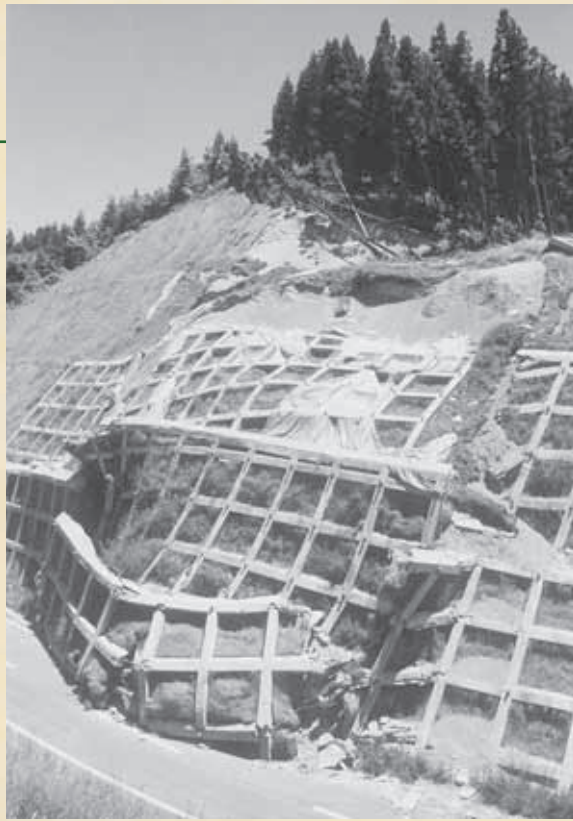
小倉地区の集中豪雨で滑落した法面
