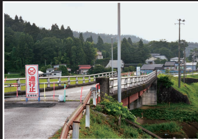
被災し通行止めが続く廣徳寺橋（門前）
