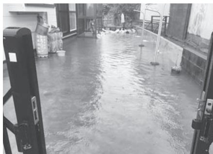
たびたびの浸水被害を受ける住家
