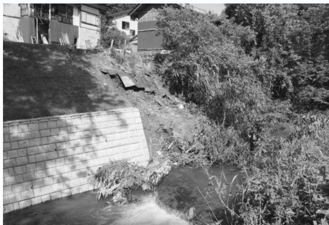
再び各地で河川護岸が崩落（内川湯ノ又）
