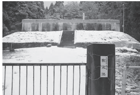
老朽化が進む配水池
