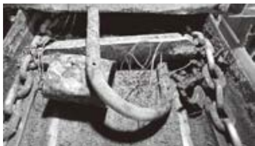
不燃物の混入で故障した処理施設のコンベヤー
