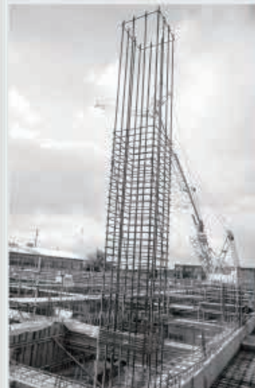
基礎杭の上に作られる柱の鉄筋。 約5mの高さがあります。
