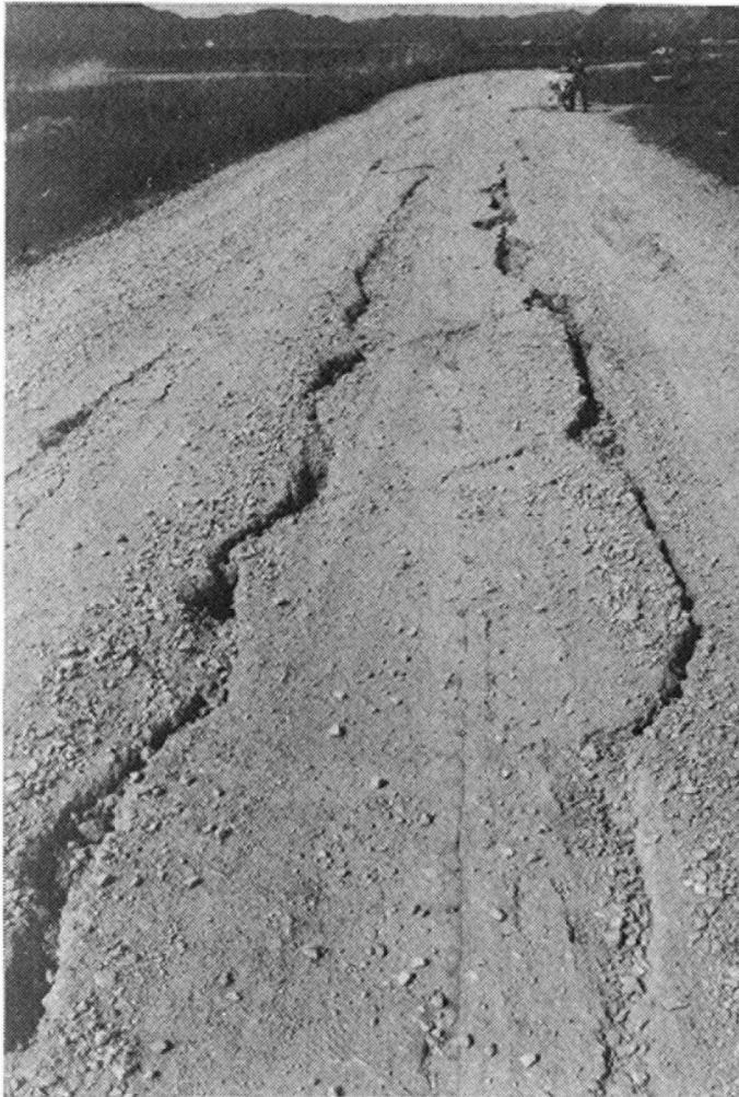
地割れした道路（大川字上湯端）
