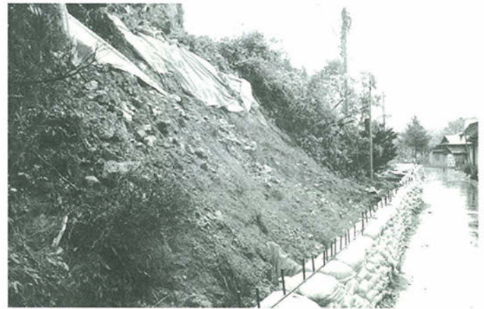
昨年8月の災害現場（崩れた土砂が戸村堰を埋めている。）
