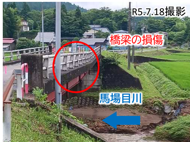
被災後の状況
