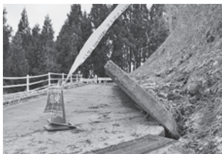
早期復旧が望まれる管理道路の擁壁
