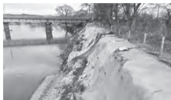
災害復旧工事を待つ大川の堤防
