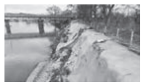
災害復旧工事を待つ大川の堤防
