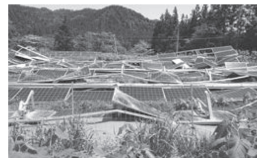
割れた太陽光パネル（5月下旬撮影）
