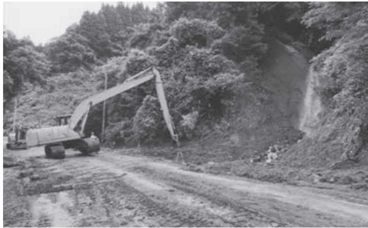
水沢の崩落現場、重機で作業中 ※右側の滝の上部から巨岩が落石した。
