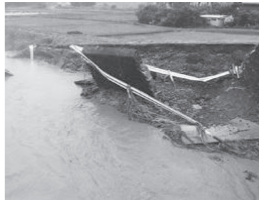
護岸が崩落した坊村橋付近
