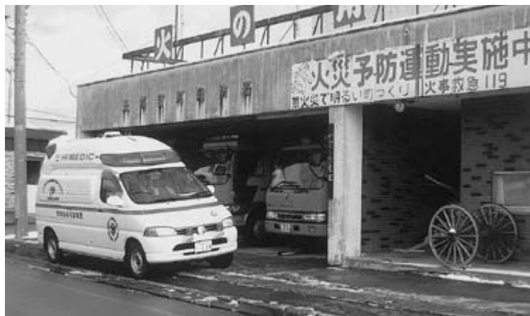
老朽化が進む消防庁舎
