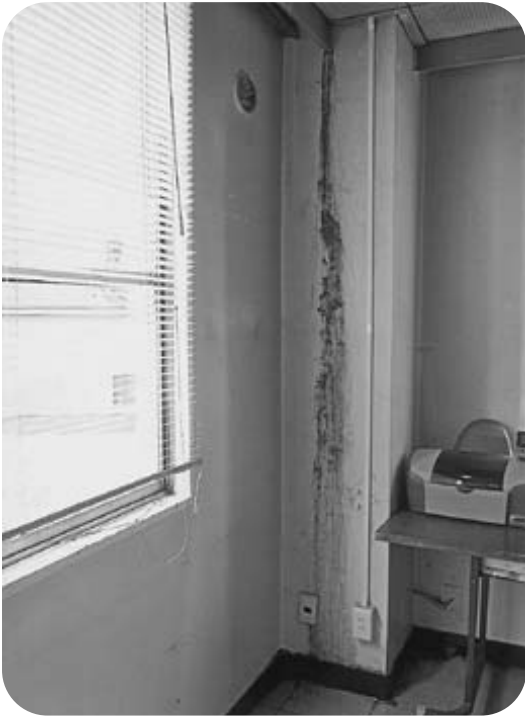
水漏れが激しい消防庁舎
