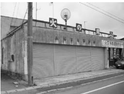
老朽化した消防庁舎
