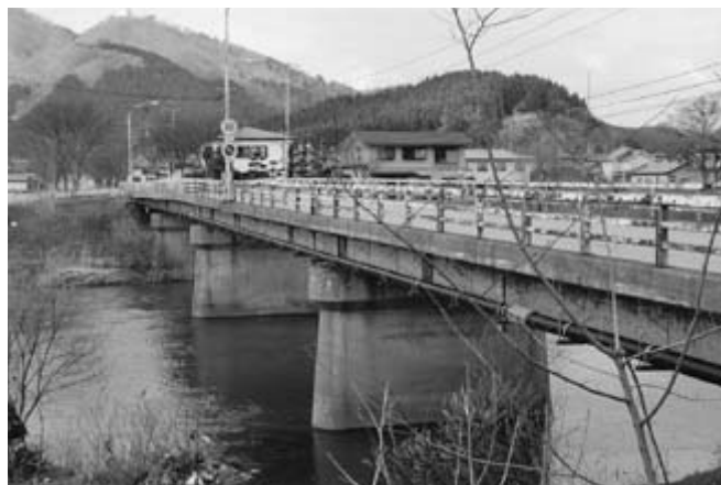
老朽化した西野橋
