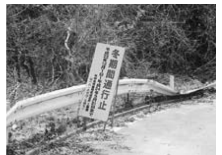
県道の崩落現場
