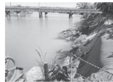
早急の工事着手を願う大川堤防の復旧
