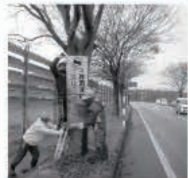
町交通安全協会では、路面凍結によるスリップ注意を呼び掛ける看板を町内9か所に設置しました。
