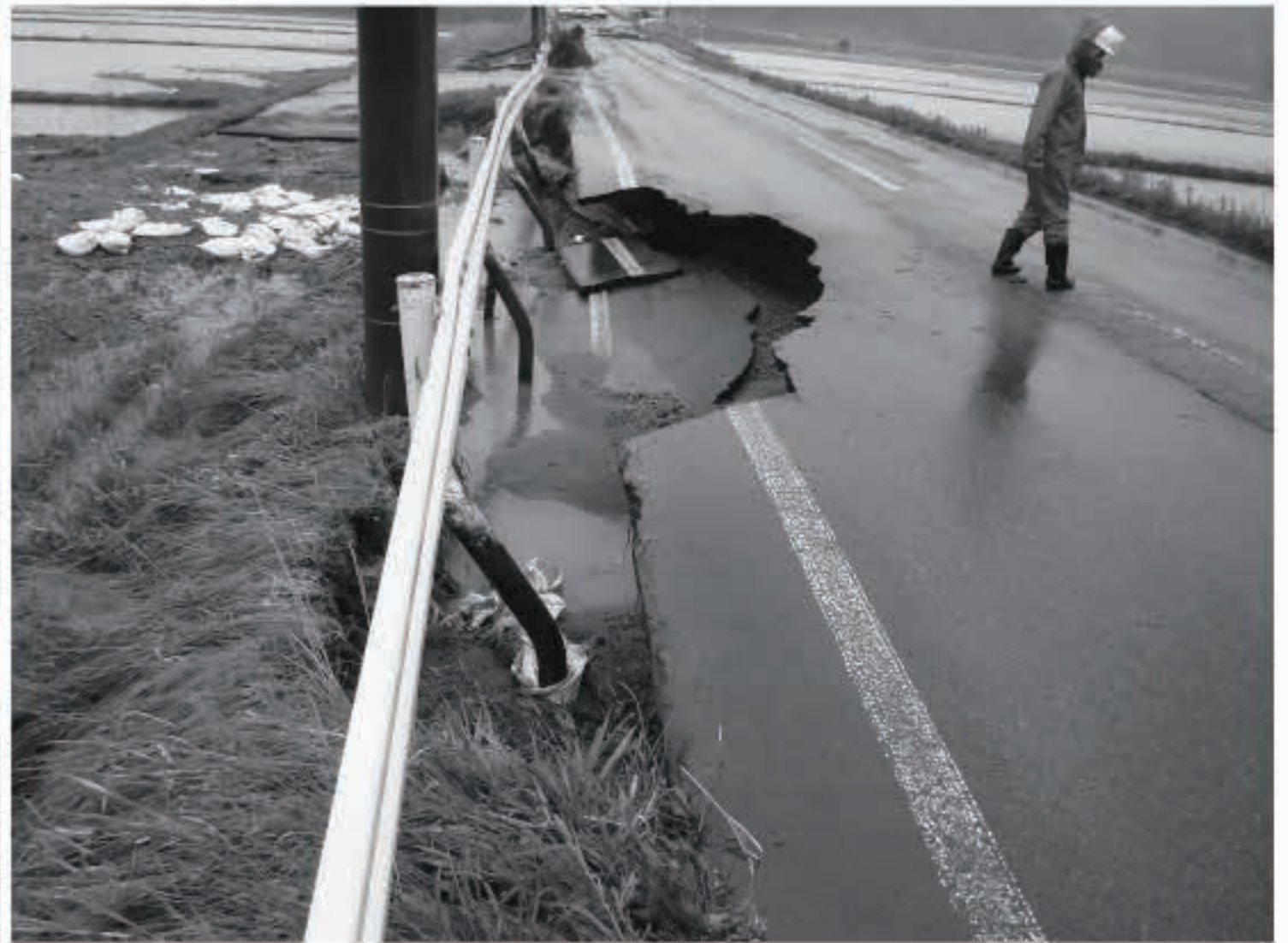
馬場目川の氾濫により、五城目外環状線では路肩と片側の車道が決壊し、一時通行止めとなる(町村)
