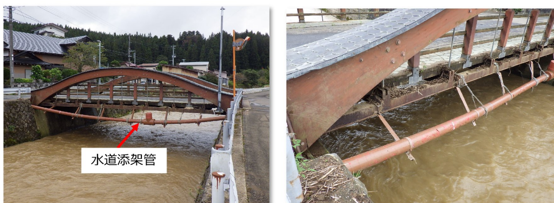
図 3.2 破損した湯ノ又橋水道添架管
