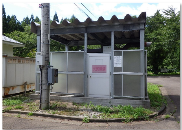
図 3.4 五城目浄水場の自家発電設備
