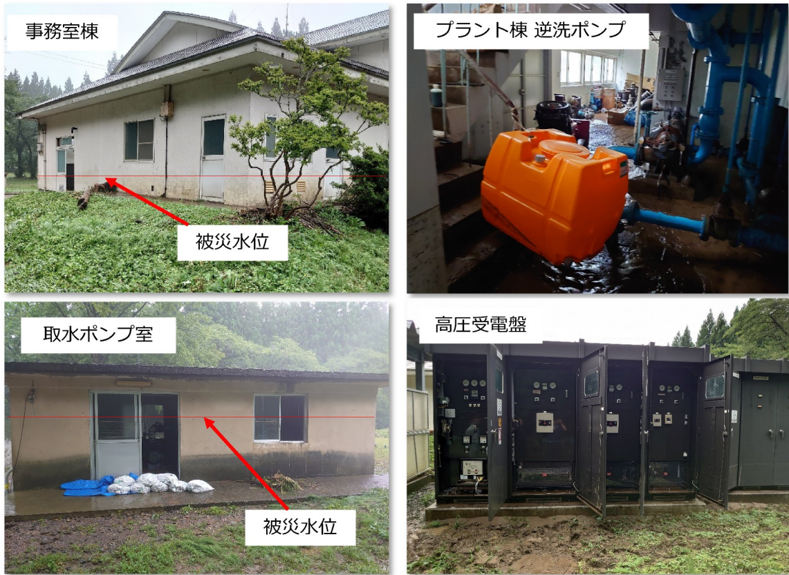
図 3.3 五城目浄水場の浸水被害
