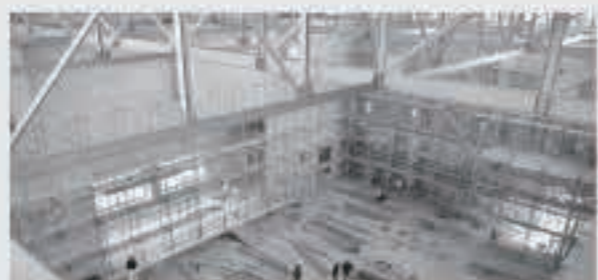
体育館内部の様子。屋根をかけるための内部足場が撤去されています。
