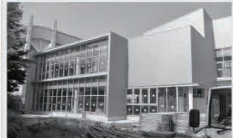
地域図書室が入るメディアセンター。外部の工事は完了しています。
