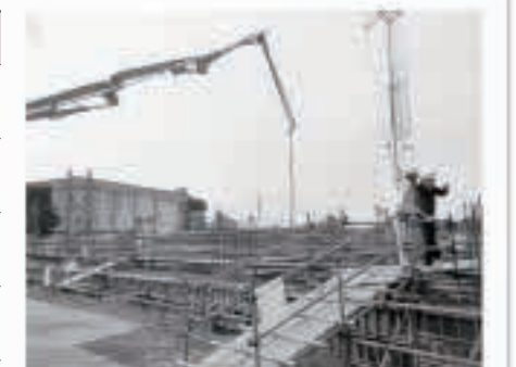
基本設計、実施設計業務を経て五城目小学校新校舎の工事を着工
