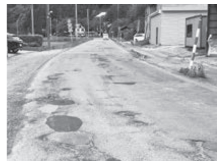
早期改修が待たれる県道4号線
